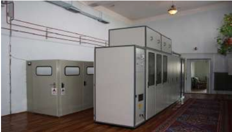
Баян-Өлгийд суурьлуулсан ТРАМ-50Л станц. 2013 он
