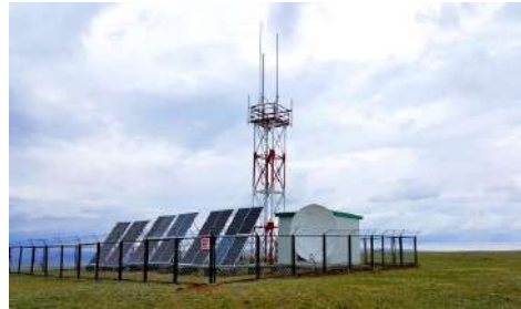
VSAT-аар үүрэн холбооны үйлчилгээ хүргэж буй станц
